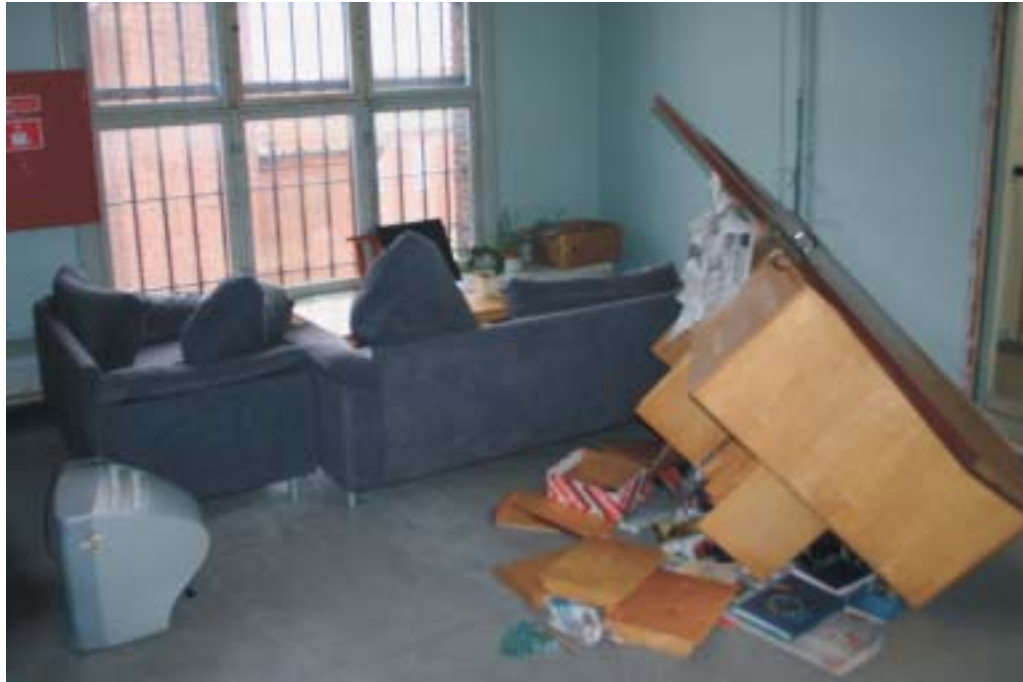
Det omfattende hærværk i Nyborg har medført skader for ca. 1 mio. kr.
